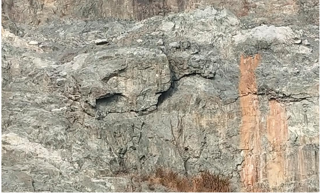
照片 5-9 W1 北段边坡+120m 台阶边坡危岩体
