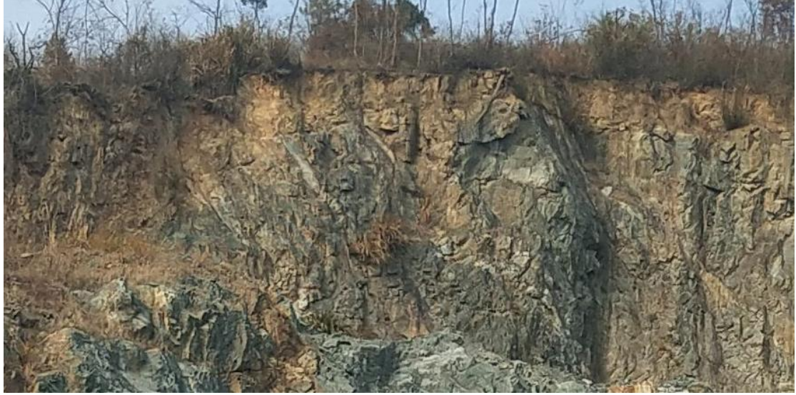
照片 5-11 W3 北段边坡+140m 台阶边坡危岩体
