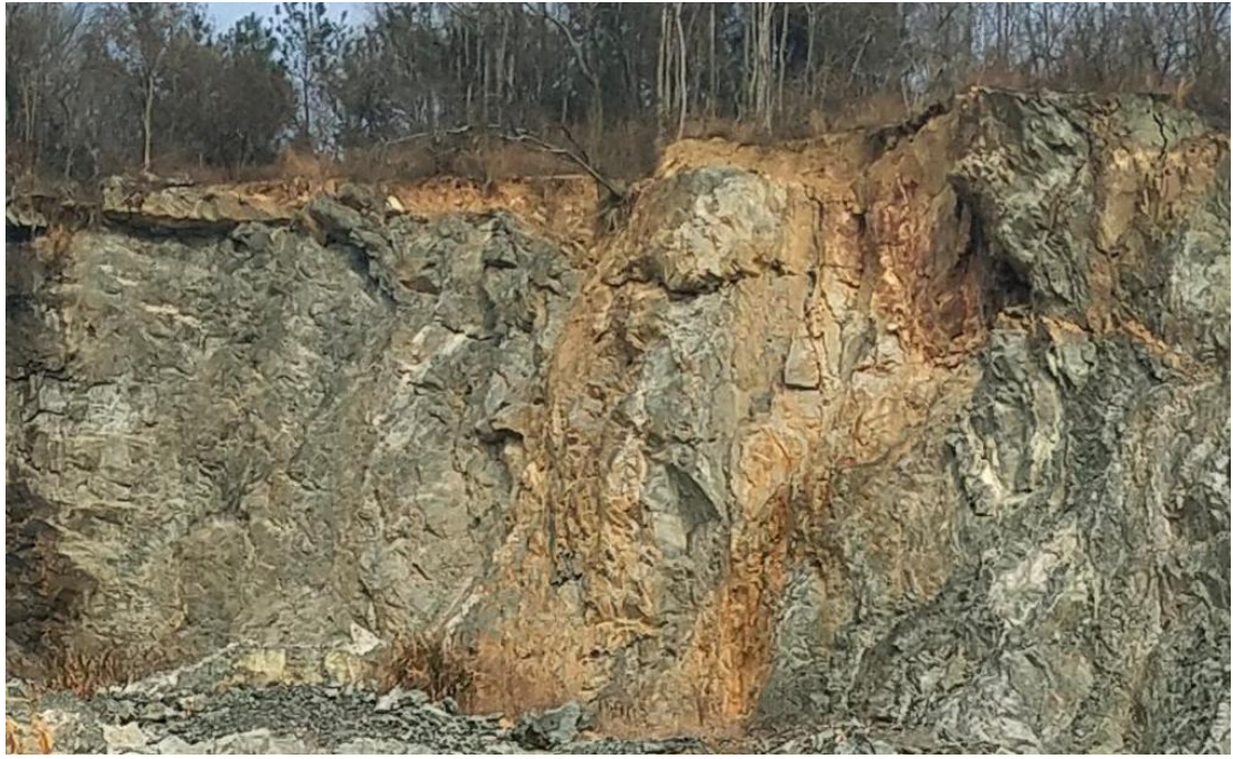
照片 5-4 W4 边坡危岩体
