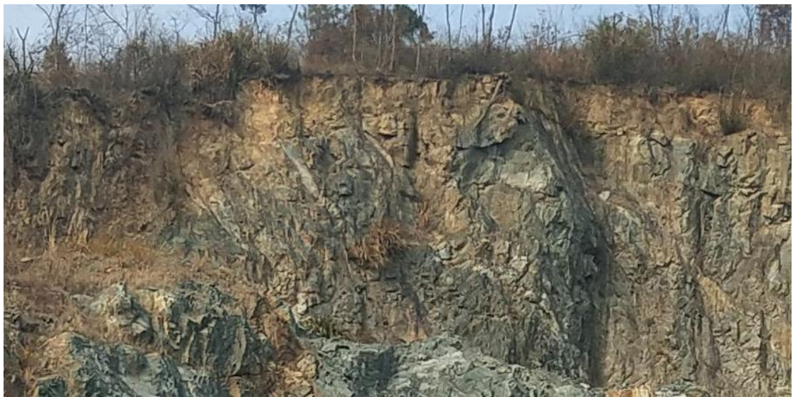
照片 5-5 W5 边坡危岩体
