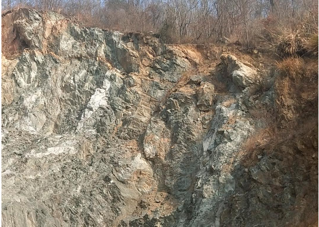
照片 5-6 W6 边坡危岩体
