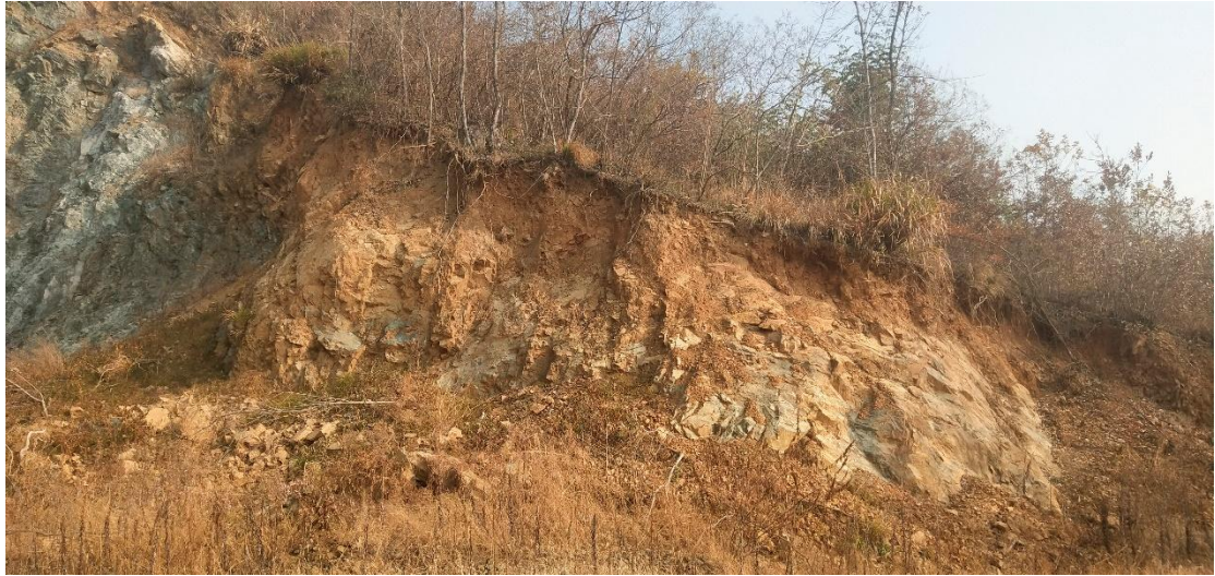
照片 5-8 宕口东侧边坡坡面浮土
