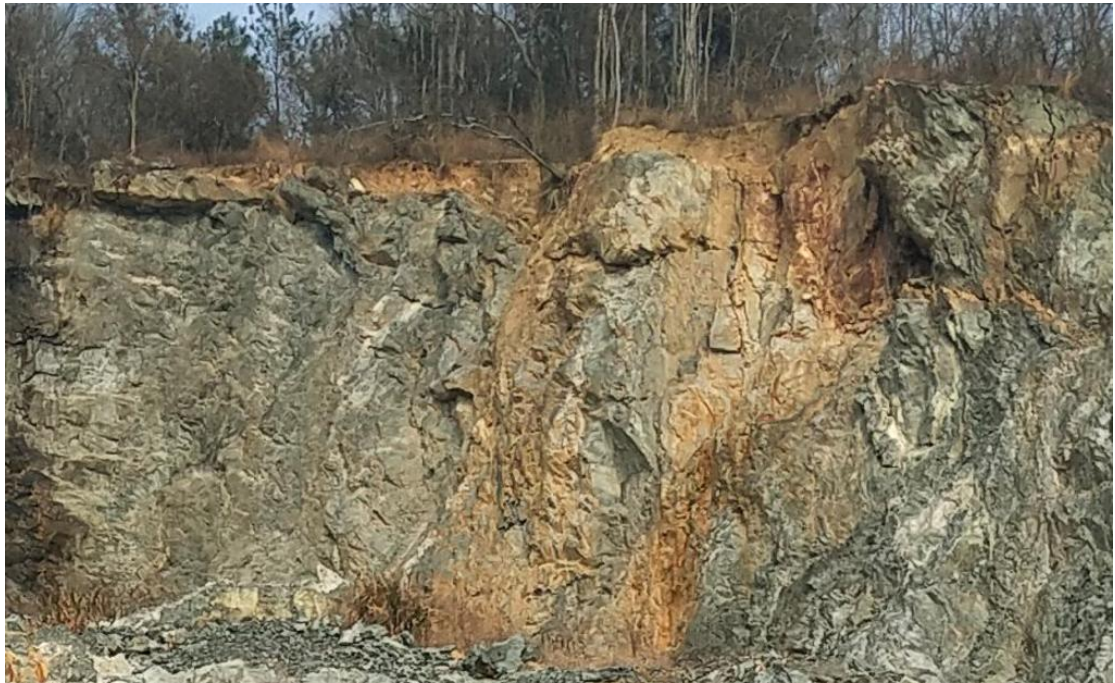
照片 5-10 W2 北段边坡+140m 台阶边坡危岩体
